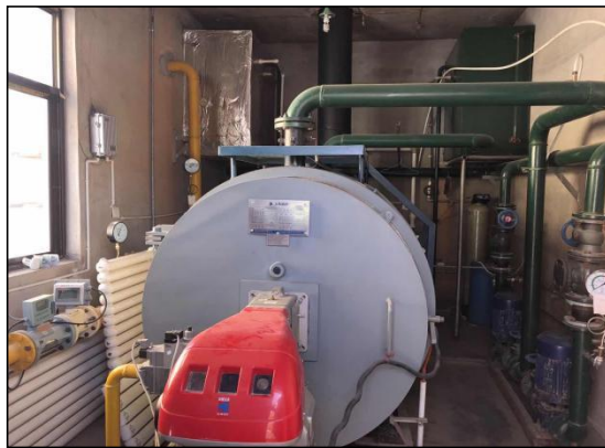
燃气蒸汽锅炉
