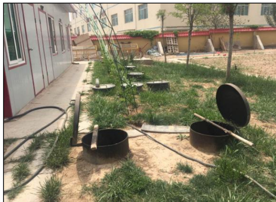
东侧地埋一体化处理设备
