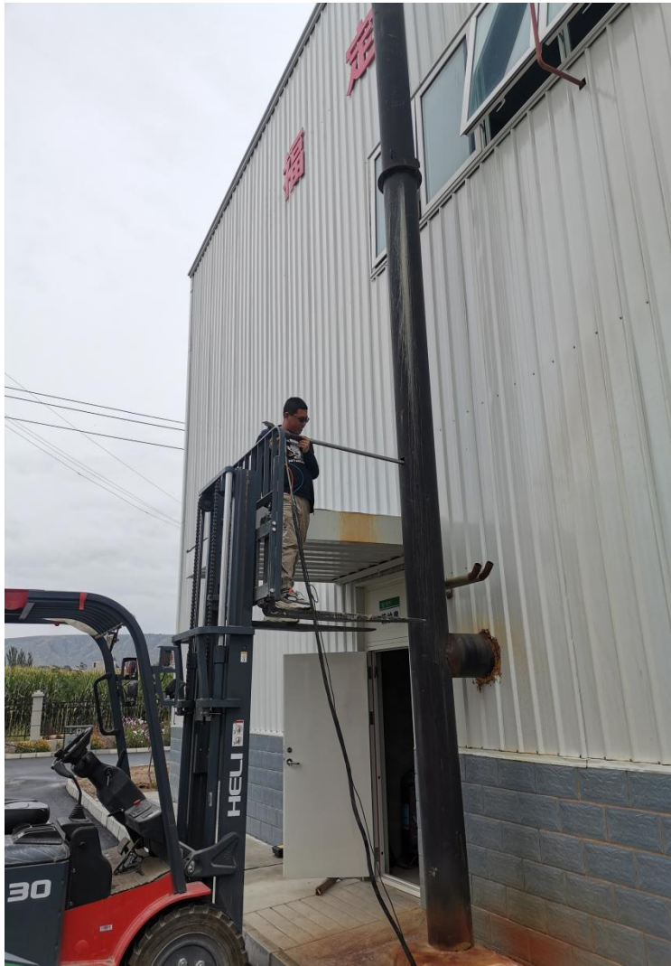
燃气锅炉排气筒
