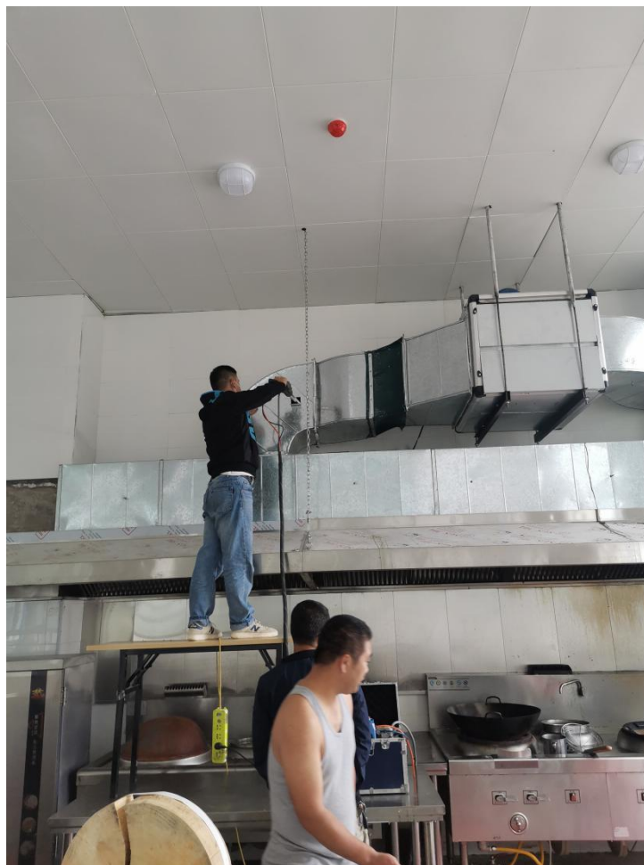
食堂油烟净化器排放口
