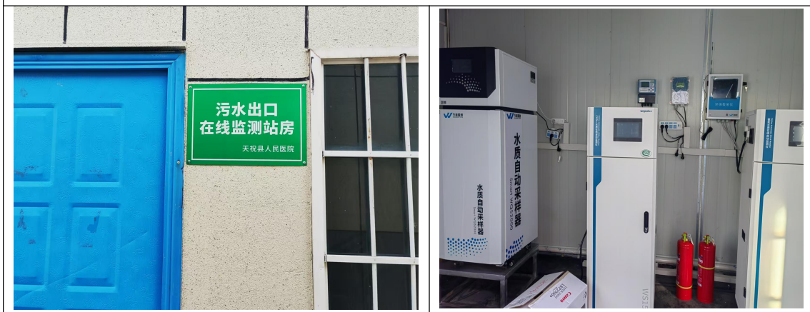
污水出口在线监测站
