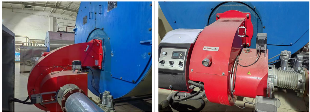
锅炉低氮燃烧系统
