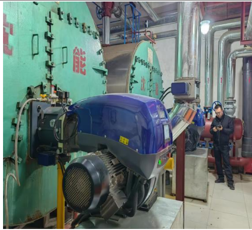
低氮燃烧系统
