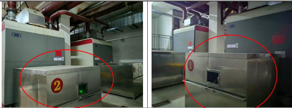
锅炉低氮燃烧系统
