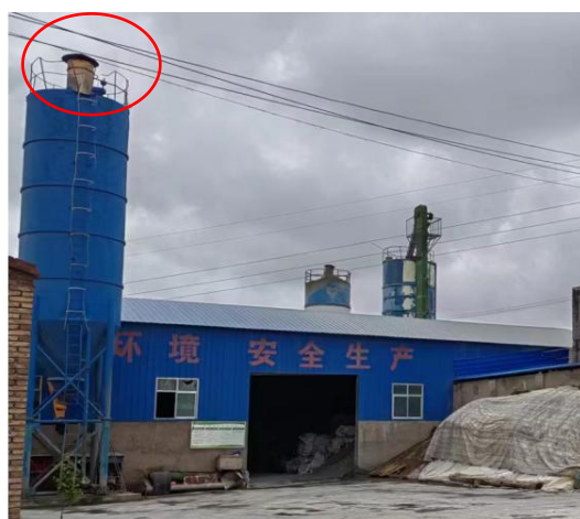
筒仓滤芯除尘器
