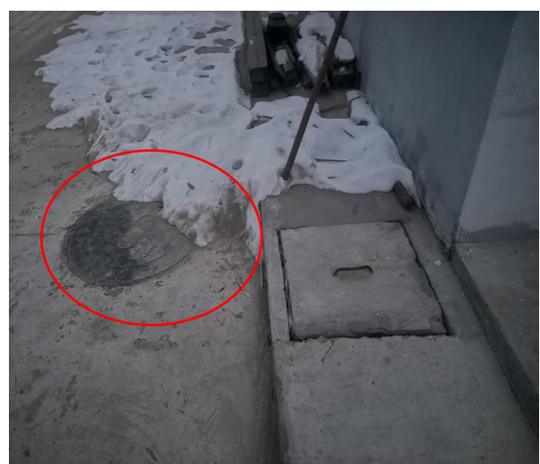
渗滤液沉淀池
