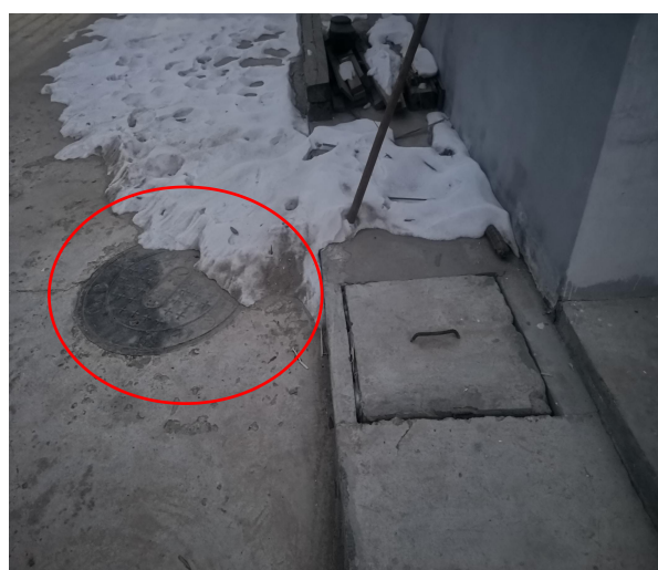
渗滤液沉淀池
